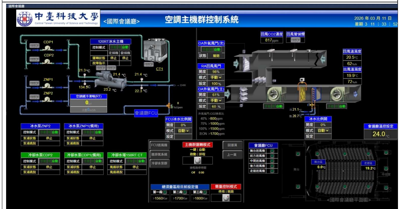
天機大樓冰水主機控制平台
